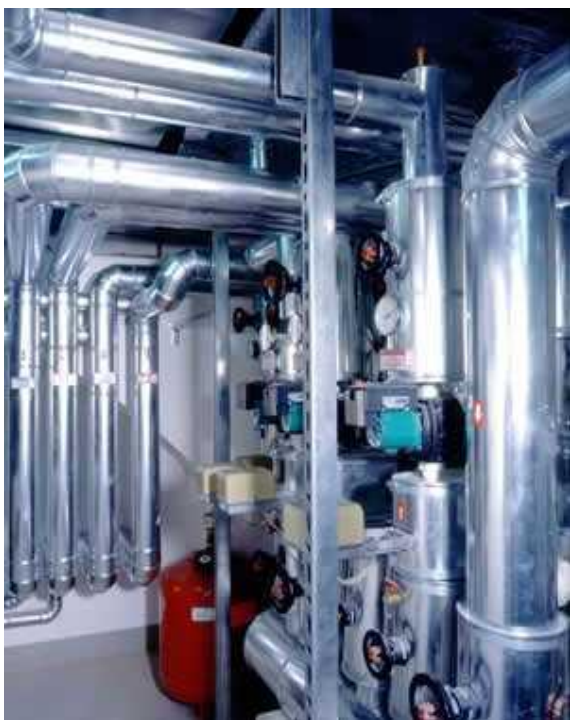
Foto 3: Wärmeverteilung in Technikzentrale
