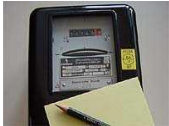
Foto 7: „Alte Generation“ eines Stromzählers, die nach wie vor in Liegenschaften vorzufinden ist.
