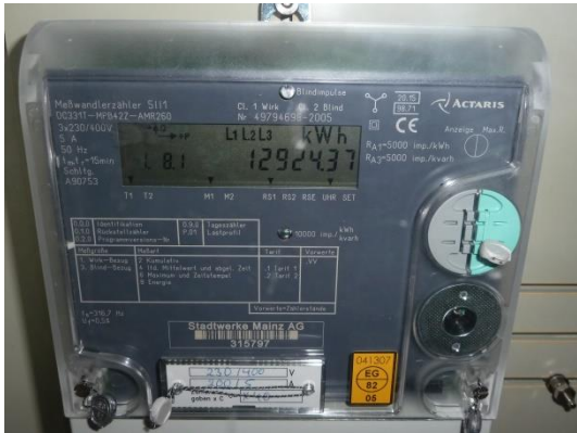
Foto 8: „Neuere Generation“ – hier Messwandlertähler mit Angabe des Faktors (eingesteckter Zettel mit „x 40“).
