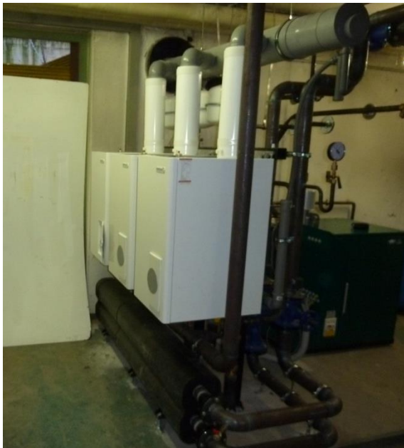
Foto 1: 3er-Kaskade und Mini-BHKW (rechts hinten), Mainz
